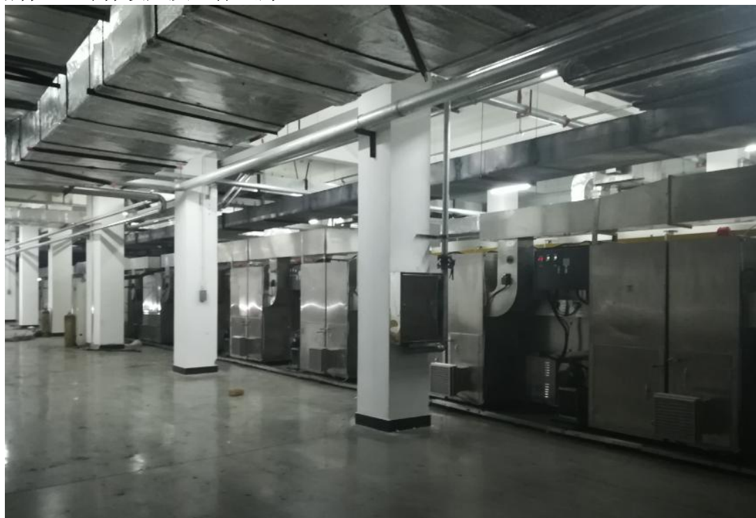
车间通风换气系统
