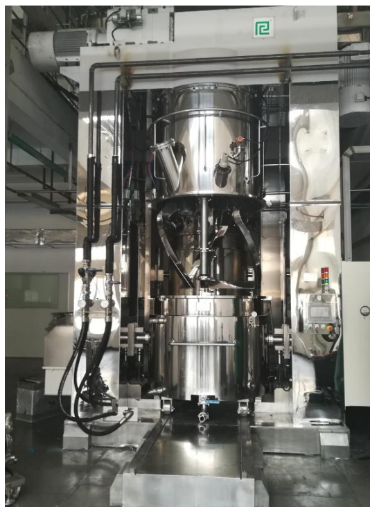
全封闭式配料罐
